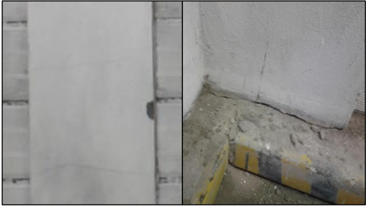
(a) Grietas a media altura de una de las franjas
