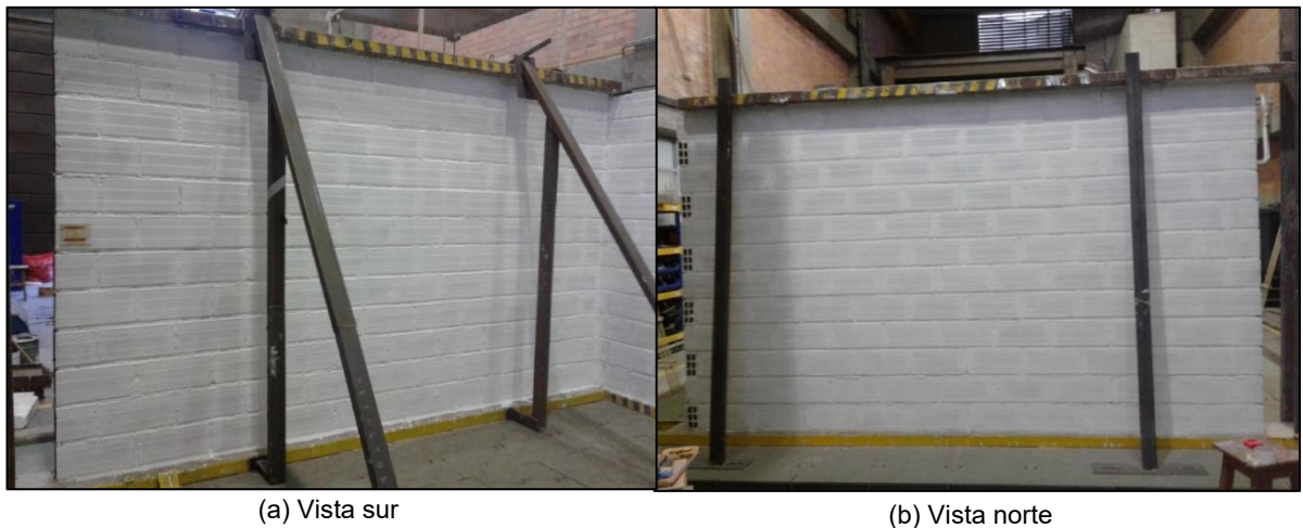
Figura 6.4 Estado del muro luego del ensayo número 2-T3-7-408-V-S
