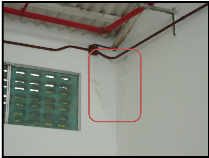
Ilustración 33 Humedad en la pared
