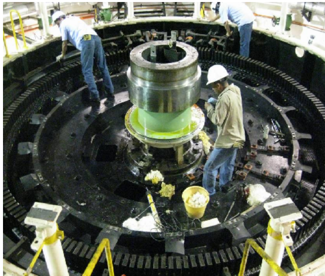
Ilustración 22. Generador central jaguas
