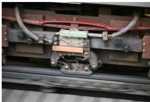
Ilustración 11. Contacto con el tercer carril.
