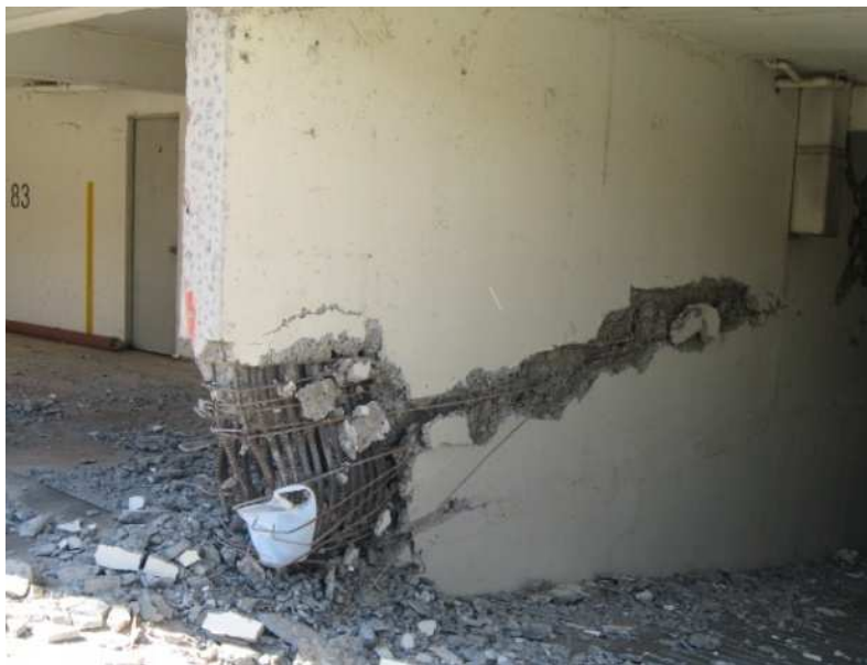
Figura 15. Colapso progresivo de muro Chile (2010). Fuente: Bonelli y Restrepo (2011).
