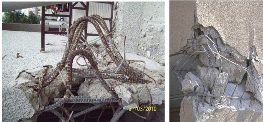
Figura 14. Falla de muros por pandeo Chile (2010). Fuente: Bonelli y Restrepo (2011).
