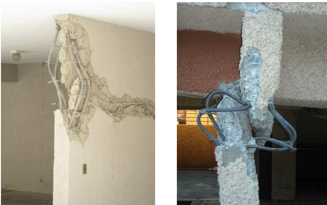
Figura 21. Efecto de pandeo en refuerzo vertical por ausencia de refuerzo transversal. Fuente: Bonelli y Restrepo (2011).
