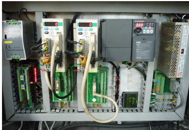
Ilustración 32. Gabinete de control torno EMCO220.
